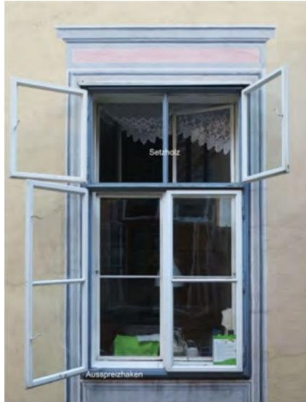
Altwiener Kastenfenster: geöffnete Oberlichten, Sitz fassadenbündig.
