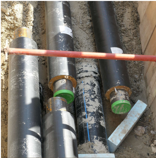
Fernwärmeleitung über Anergienetz
