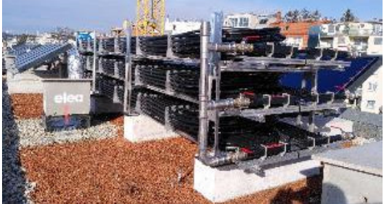
Solarabsorber zur Regeneration Erdsondenfeld
